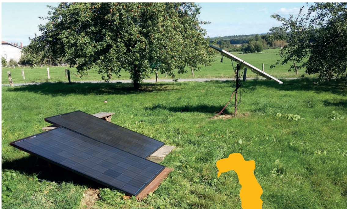
Les 2 panneaux du kit autoconsommation lors d'un montage d'essai au sol. En arrière plan, les premiers panneaux sur tracker fonctionnant en charge de batterie.
